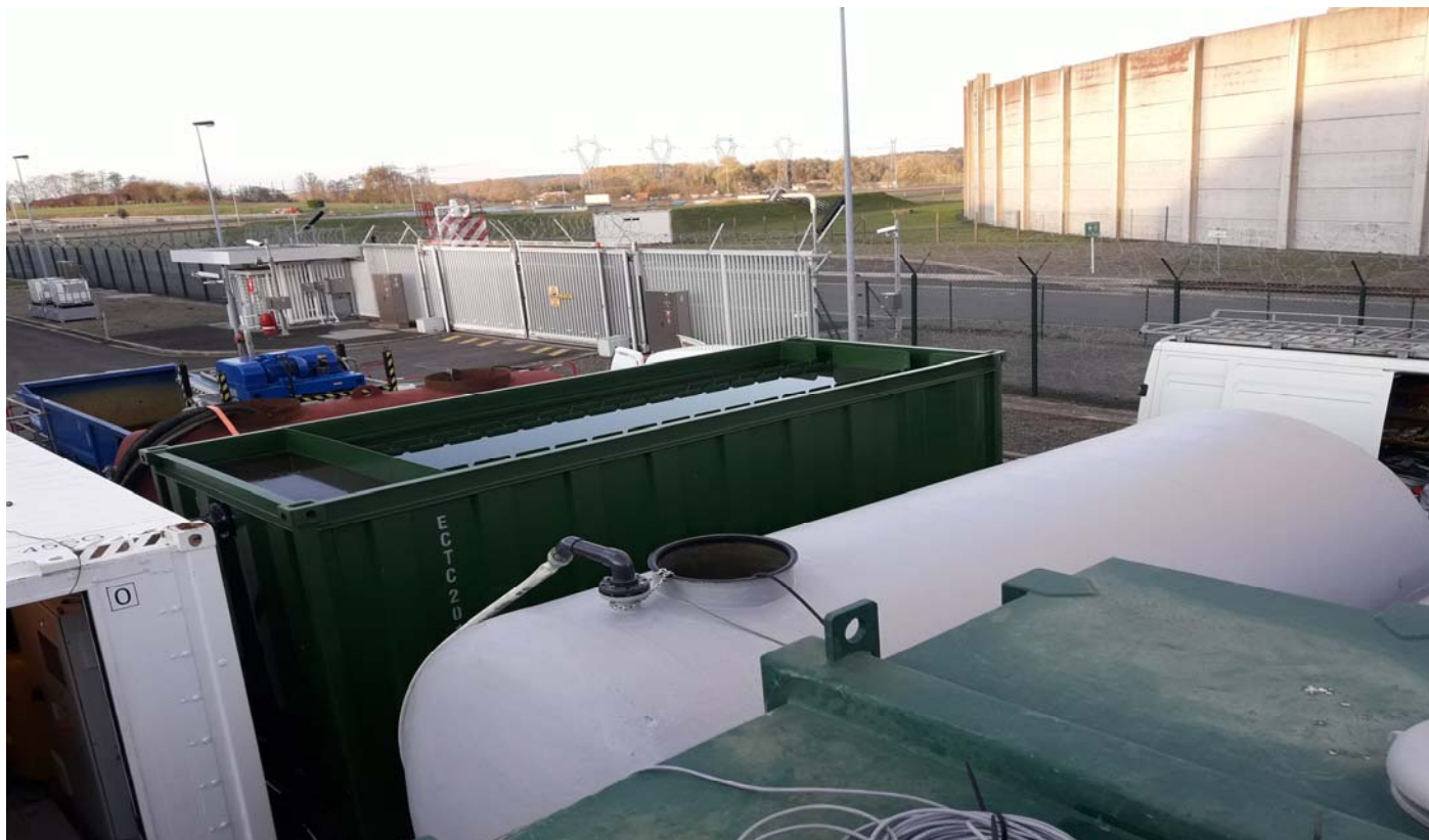
DECANTEUR 20 PIEDS EN FONCTIONNEMENT (CENTRE DE PRODUCTION NUCLEAIRE DE CICAUX)
